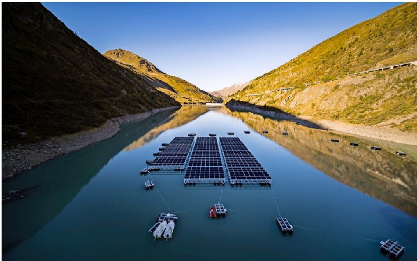
Sur le barrage des Toules, 18 plateformes doivent encore être ajoutées pour couvrir au total une surface de 2200 m 2 . KEYSTONE
